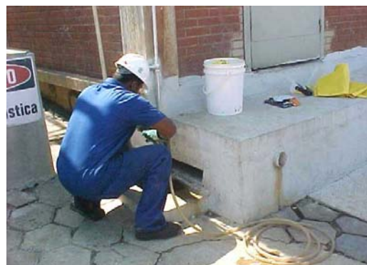
Foto 12 - Linha de Água de Emergência
